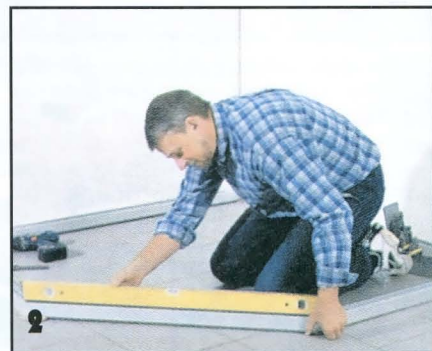
Собранное основание выставляют строго горизонтально с помощью длинного уровня. Правильная и аккуратная подготовка основания — залог успеха в дальнейшей работе.
